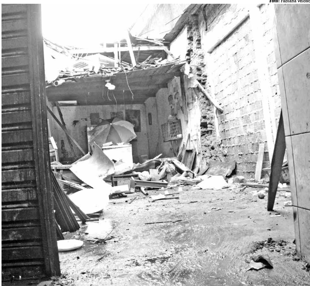
Teto de uma loja localizada na Feira Central caiu na semana passada, provocando prejuízos materiais
